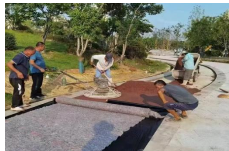
（图3：西安沣河生态湿地公园的透水混凝土铺装现场，演示其优异的透水性能。图片来源：项目施工记录）
