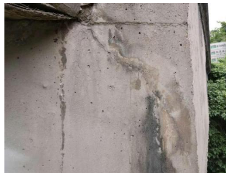
图 1 盖梁斜向裂缝
