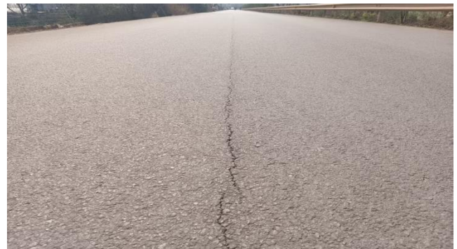
图1 路基沉降不均产生的纵向裂缝（右幅路基为填方）
