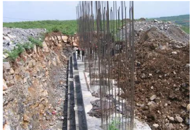
图 1 桥梁桩基成孔施工中严重塌孔现场
