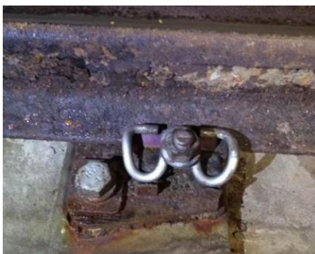
图5 道床扣件、钢轨等金属件锈蚀严重
