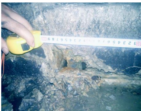
图6 道床混凝土脱空、离析
