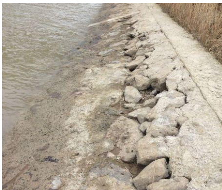
图1 传统硬质护坡结构破坏生态系统图
