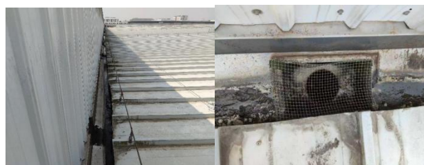
图 1、2 金属屋面翻新前情况
