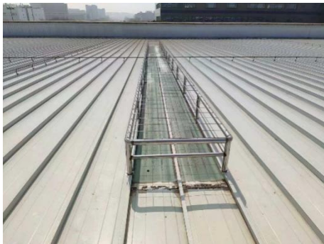
图3 屋面翻新前天窗情况
