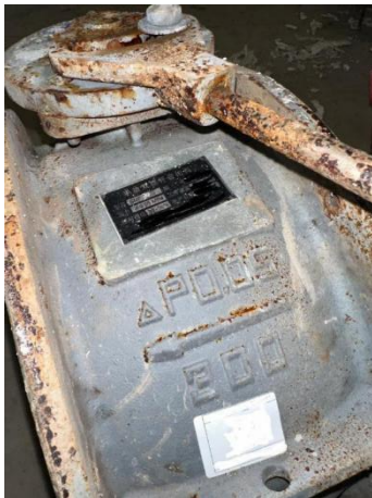
图2 严重锈蚀的密闭阀门
