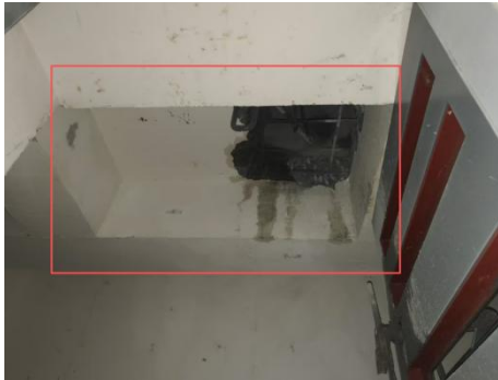
图1 红色方框内为被混凝土封堵的风井
