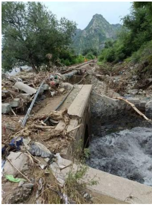
图1 清江电站暴雨所致塌陷图
